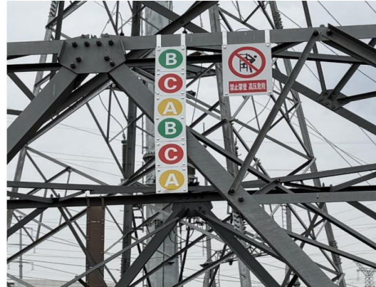
塔基悬挂警示标志
