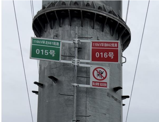
塔基悬挂警示标志
