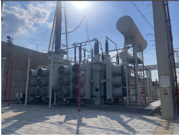
主变防火墙及事故油坑
