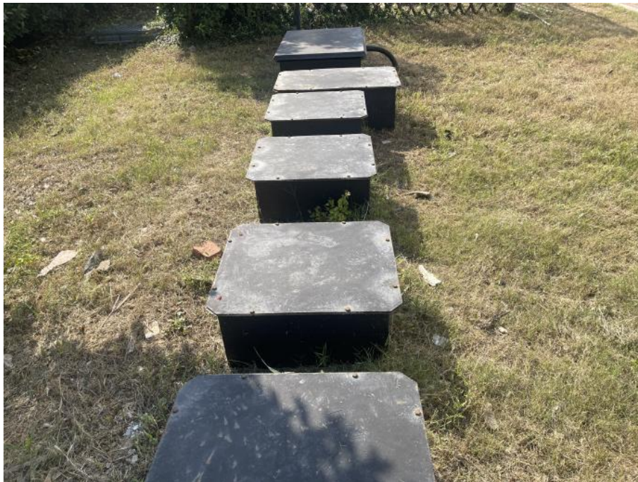
图 9.2-2 淮南站站内现有埋式生活污水处理设施
