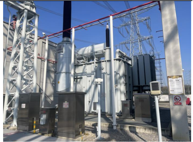
高抗防火墙及事故油坑
