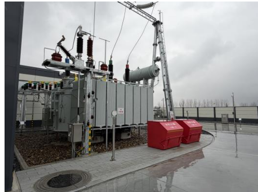
主变压器（1#主变）
